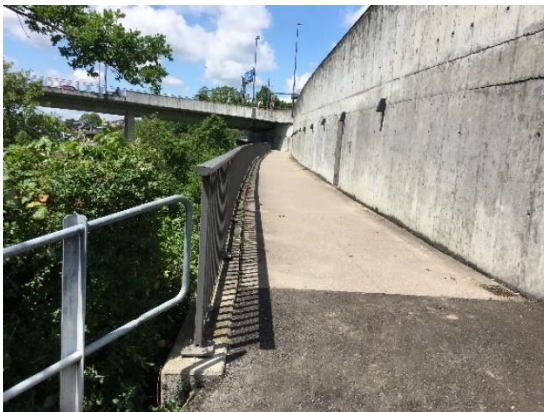
Durchgang für Fussgänger und Velofahrer zu den Kantonsstrassen K114 / K121 und zur Bushaltestelle Boldi
