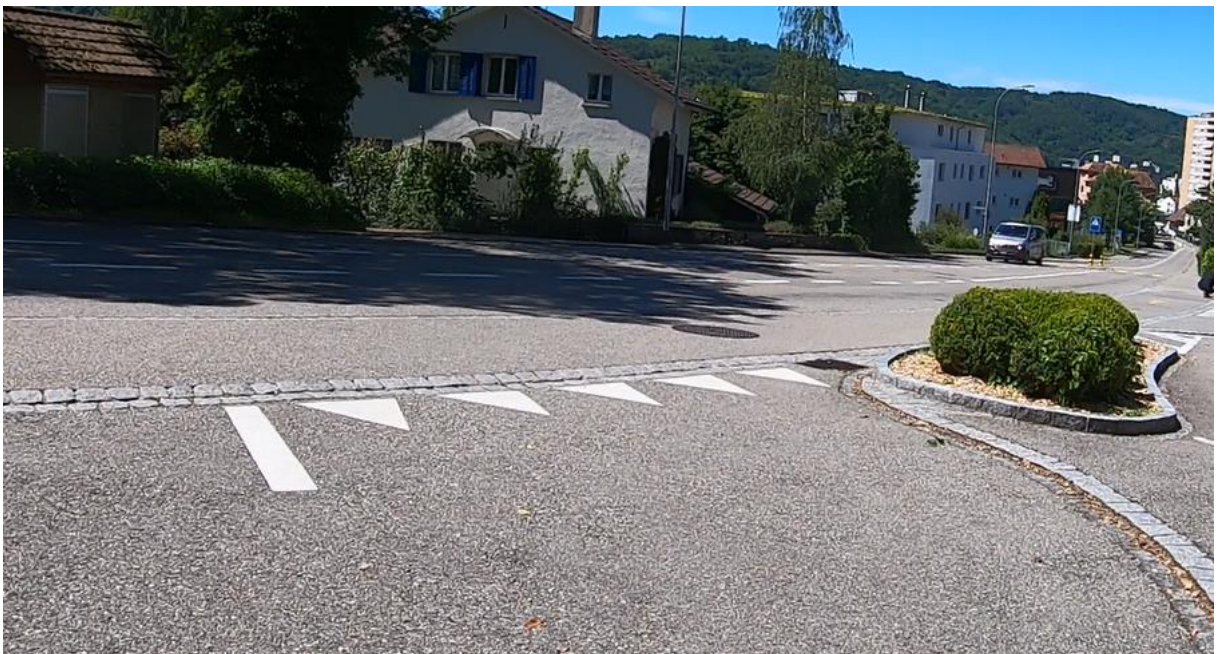
Abbildung 20 Nicht zulässige Vortrittsmarkierung bei Trottoirüberfahrt
